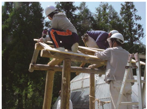
あったか村で井戸小屋の屋根に登る (2008年 白松博之さん撮影)
