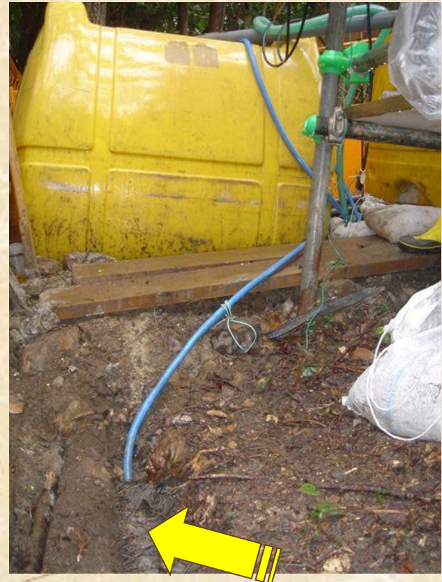
ホースの先端から泥水を垂れ流した痕
