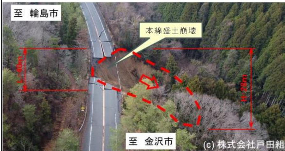
写真2. 盛土崩壊(のと里山海道13.8kp付近)
