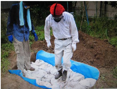
写真35 穴を掘って、ブルーシートを敷き、そのうえから土のうを、並べて配置し、無駄な空間をすくなくする。
