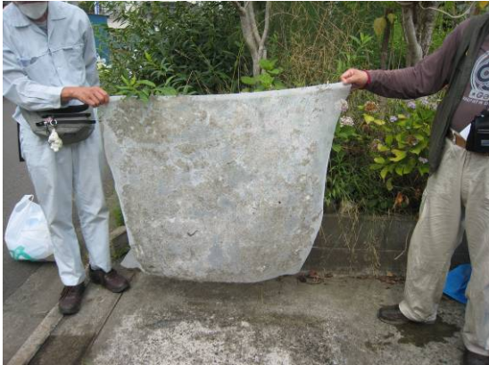
写真 2 6 アルファ・デンプン+寒冷紗を剥がした面 にへばり付いたコンクリートの剥離部分
