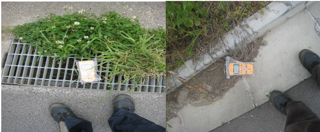
写真5 土砂の堆積した側溝
